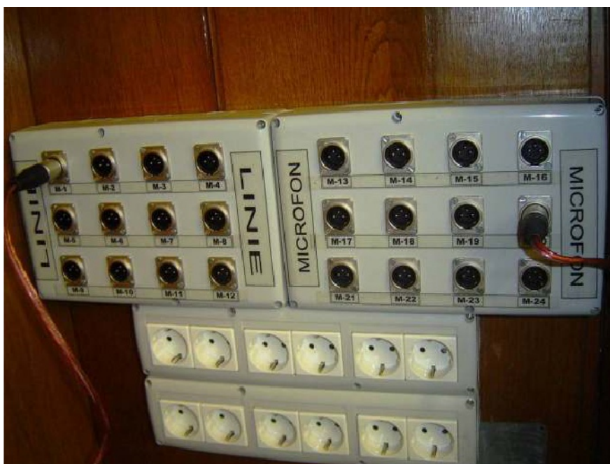
Figura 24: Distribuitoare de sunet, unde jurnaliștii își pot conecta aparatura de înregistrare a sunetului, și prize de tensiune, care pot fi utilizate pentru alimentarea aparaturii
